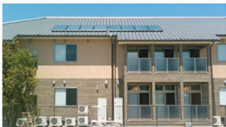
社会福祉法人施設への太陽熱温水器の設置
