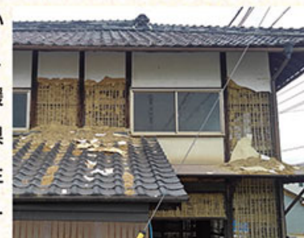
水害の爪痕。2階壁面まで浸水した家屋(真備町)
