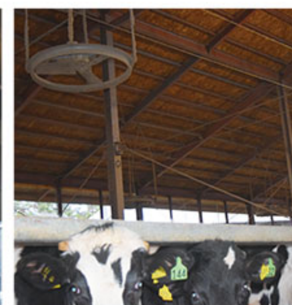
空気交換、循環を担う換気扇。 牛舎全体に一定間隔で設置
