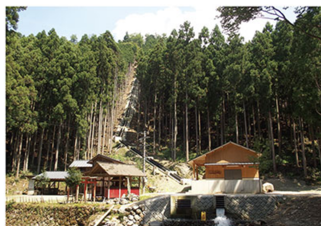
東吉野村つくばね発電所 上流の水を山の上に引き、導水管を流れ落ちる勢いで発電する
