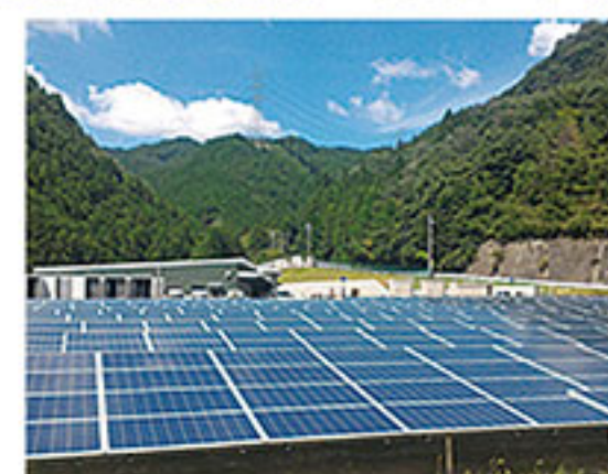
吉野事業所(ハートフルコープ吉野)の屋上太陽光パネル
