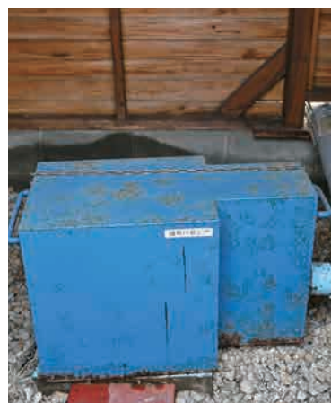
「ただの炭酸水」の水を汲み上げる深井戸ポンプ
