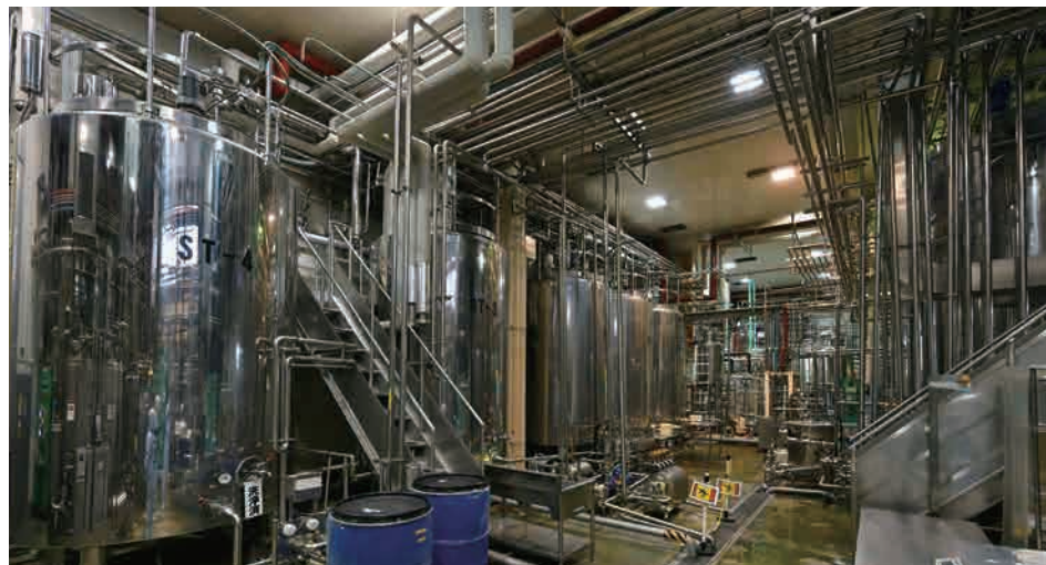
工場内部 無数の巨大なタンクと縦横に走るパイプ
