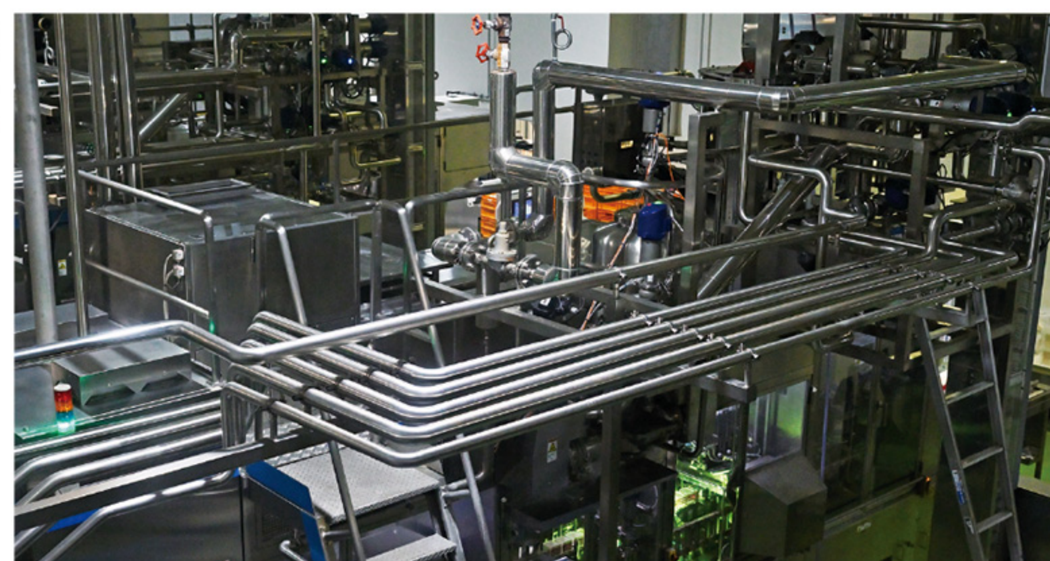
工場内はパイプだらけ。衛生管理上中身を見ることはできない
