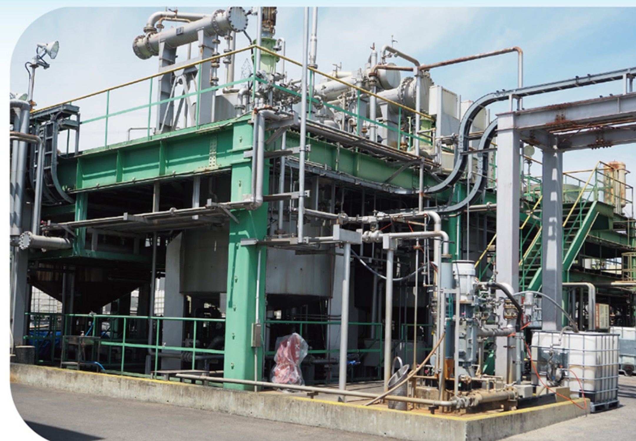
C-FUEL製造プラント
