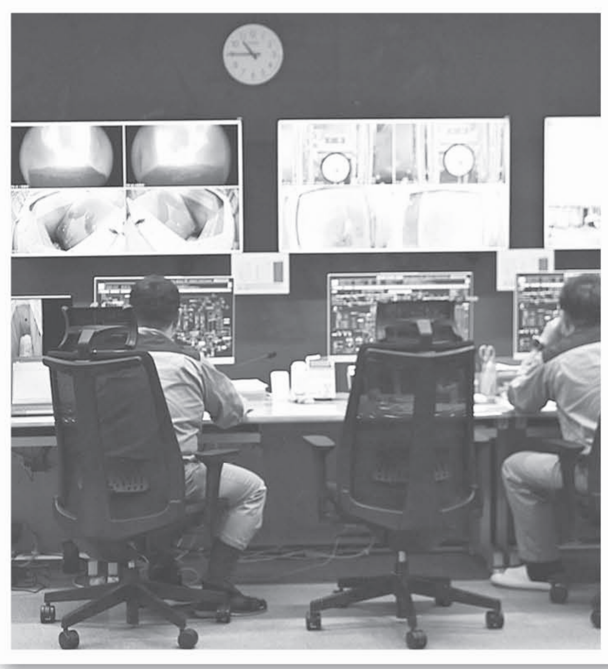
中央制御室では24時間交代で、施設の監視と制御をしているよ
