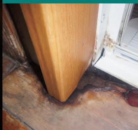
浴室・台所の水漏れ
