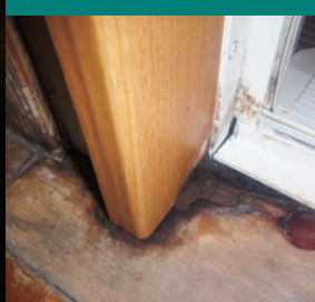
浴室・台所の水漏れ
