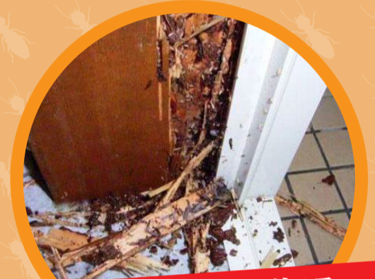
浴室桝木の傷み
